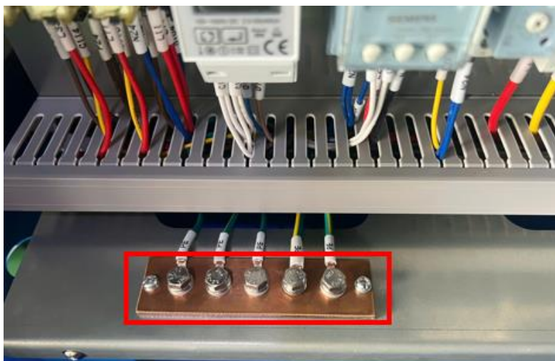
Hình 13: Vị trí thanh tiếp địa trong tủ
